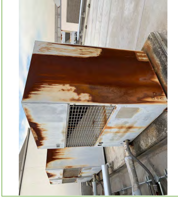
現況写真①（空調設備）
